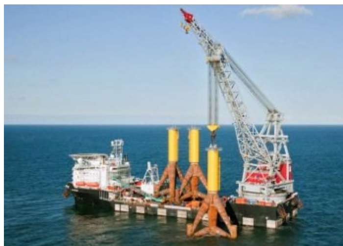
Abb. 1-5: Ein Kranschiff platziert einen Tripod auf die zuvor gerammten Pfähle im OWP Borkum West II. Quelle: windpoweroffshore.com/2013/02/21/borkum_west_2_due_for_completion_by_autumn/#.UWQRmTdK7CA .
