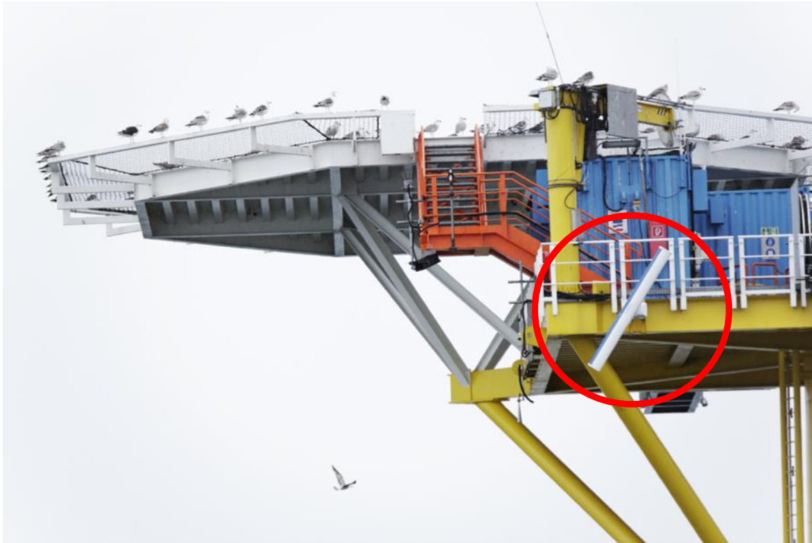
Abbildung 32: Beispiel einer Anbringung eines Radargeräts zur Erfassung des Vogelzugs auf einer Umspannplattform.
